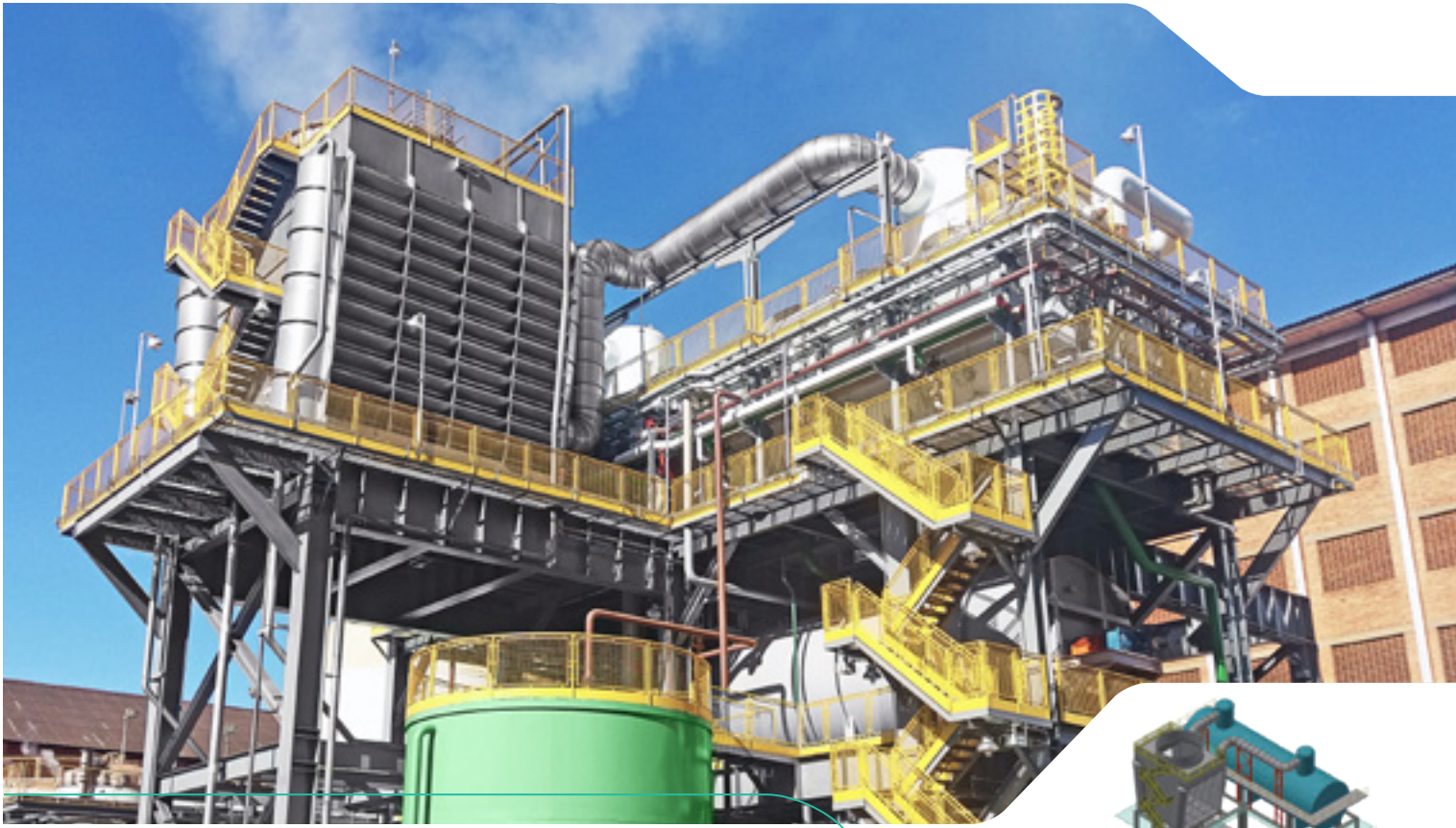
Condensador Evaporativo instalado em Cozedor Contínuo com capacidade de 2.800 HL Evaporative Condenser installed on Continuous Vacuum Pam with capacity of 2.800 HL Condensador Evaporativo instalado en Cocinador Continuo con una capacidad de 2.800 HL
